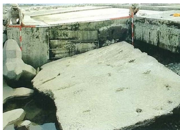
【図4-6 底面の空洞化（土砂流出）によるエプロンの陥没】
