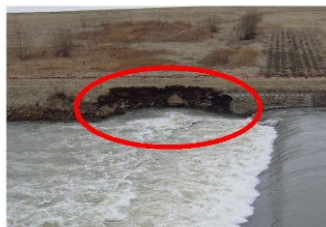
護岸工の損壊
