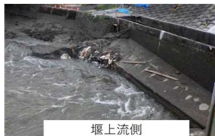
【写真1 パイピングによる漏水状況】
