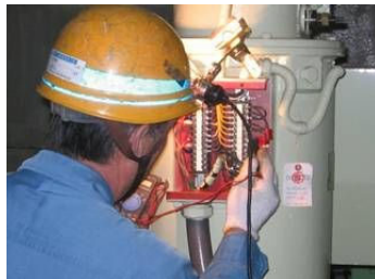
テスターによる電圧測定
