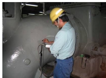
図 2.1.15 ポンプの腐食診断
