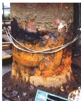
図 2.1.17 吸込配管の腐食の例
