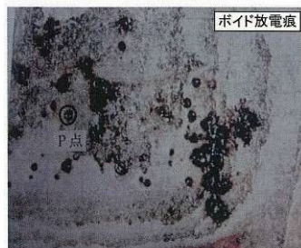
図 2.1.12 電動機固定子コイルの絶縁損耗の例
