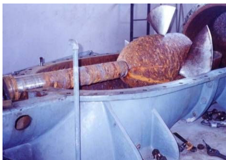
図 2.1.16 主軸、インペラの腐食の例
