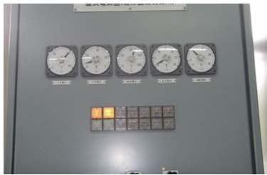
盤面計器による測定
