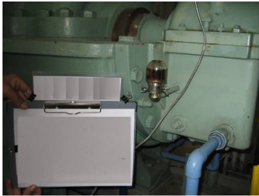
(拡大写真) 油量は油面計中央値で正常であるが、黒ずんだ油の状態である。
