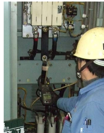
クランプメータによる電流測定
