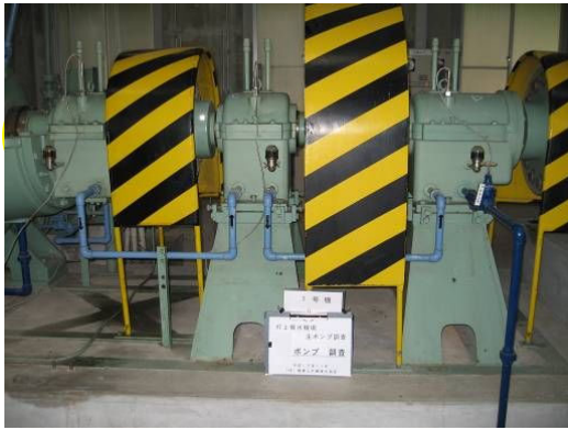
油面計にて、油の状態と量を確認する。
