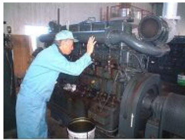
図 5.2.45 ディーゼル機関での点検状況
