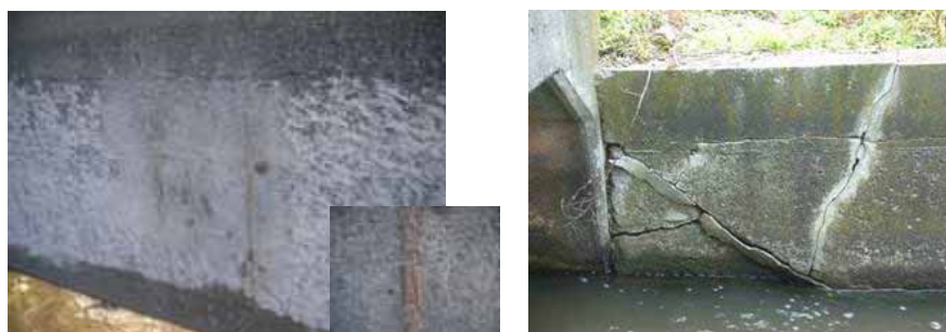
図-8.1.1 健全度評価 S-2 の開水路
