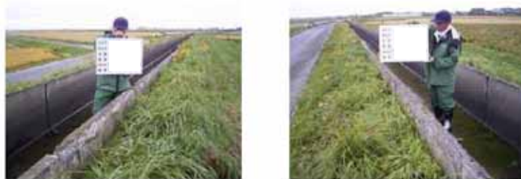
図-8.1.2 健全度評価 S-3 の開水路
