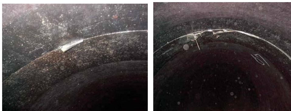
写真 2-4 継ぎ手部劣化(継ぎ手ラバーガasketの離脱)
