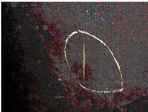
写真 2-1 管壁のひび割れ・欠損 (PC)
