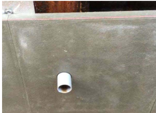
写真 5.2-11 ウィープホールによる導水処理（例）
