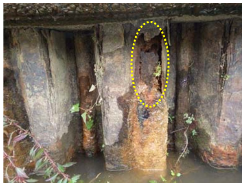
写真 1.2-3 断面欠損した鋼矢板の例
