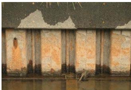
写真 1.2-1 腐食代が残存する鋼矢板水路の例
