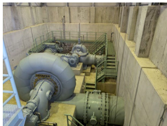
ポンプ室内部
