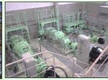
〔第1排水機場ポンプ全景〕
