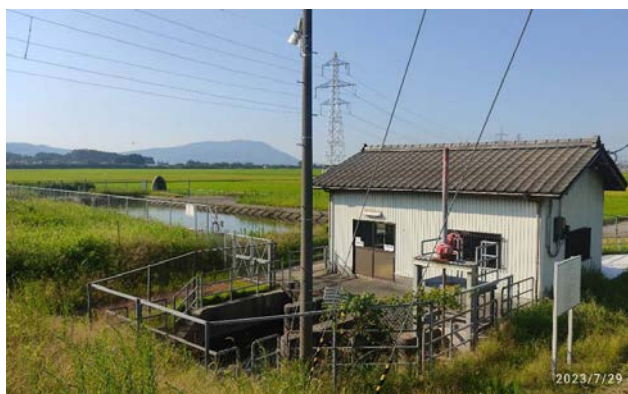
配水槽式自然圧 PLS(藤島機場)
