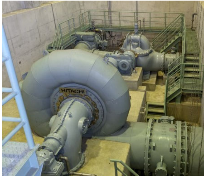
水力駆動式ポンプ（北海道：七丁目揚水機場）
