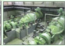
〔第2排水機場ポンプ全景〕
