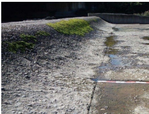
固定堰に生じた摩耗
