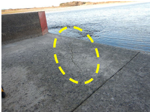
上流側エプロンに生じたひび割れ
