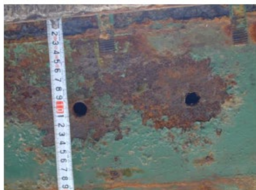
ゲートの腐食（孔食）
