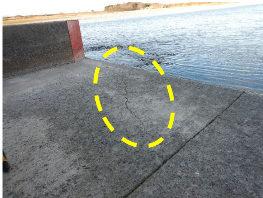
上流側エプロンに生じたひび割れ
