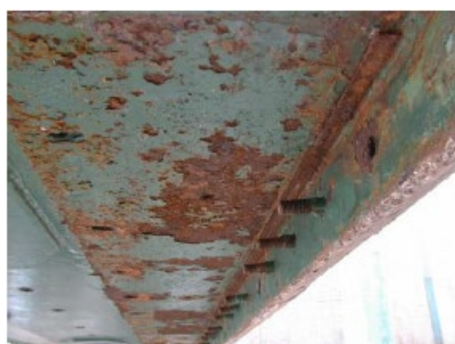
塗膜の剥離（ゲート扉体底部）
