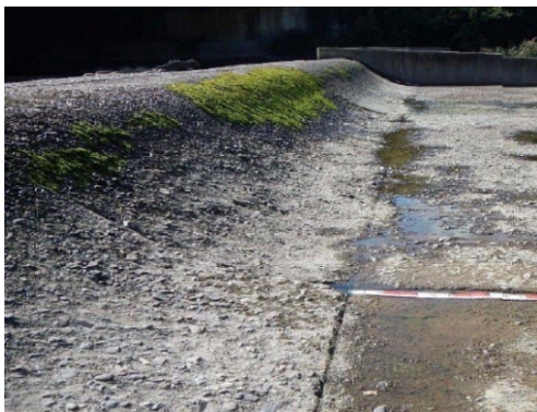
固定堰に生じた摩耗
