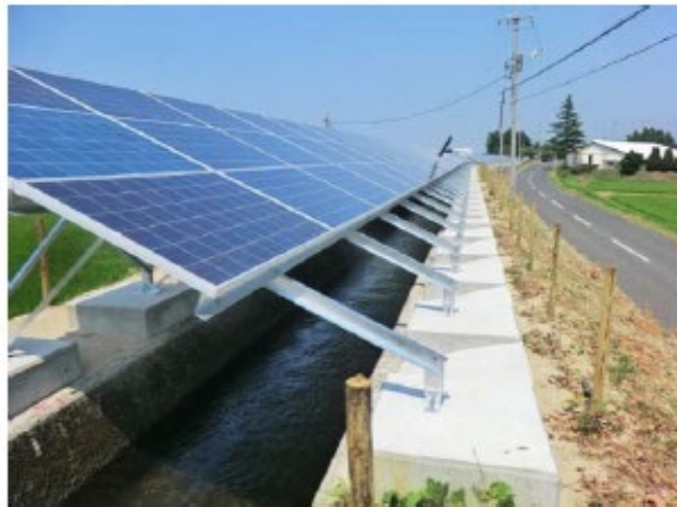
写真 参2-2 用水路の上部に設置した太陽光パネル
