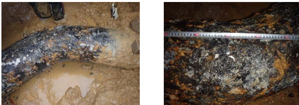
図 1.1-7 石礫等を含んだ埋戻し土の転圧による塗覆装の損傷例
