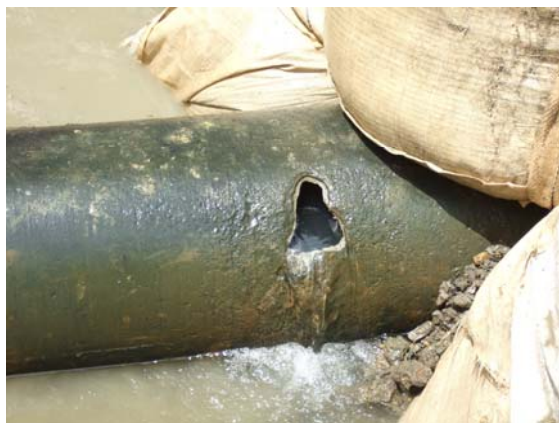
図 1.2-2 断面欠損が生じたダクタイル鋳鉄管の例
