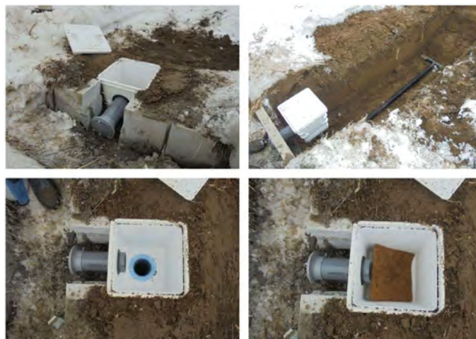
用水路からの取入口における給水柵の設置状況 （地区事例：轟地区（秋田県））
