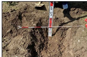
幹線パイプ上部の疎水材
