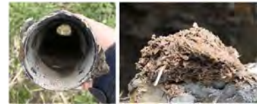
既設暗渠の経年劣化状況
