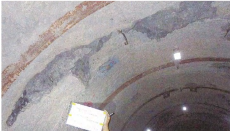
図-4.11.5 トンネル覆工部の変状
