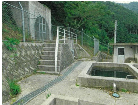
図-4.12.1 給水施設設置事例
