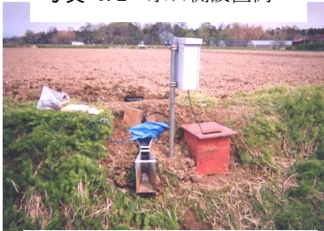
写真-6.3 落水口側設置例
