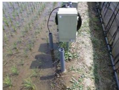
写真-6.10 水位センサー式水位計設置例 2
