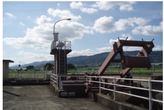
写真-20.1 水位調整ゲート(1)
