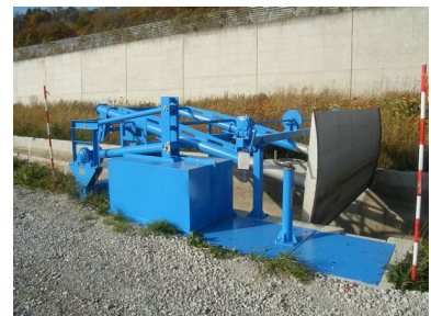
写真-20.2 水位調整ゲート(2)
