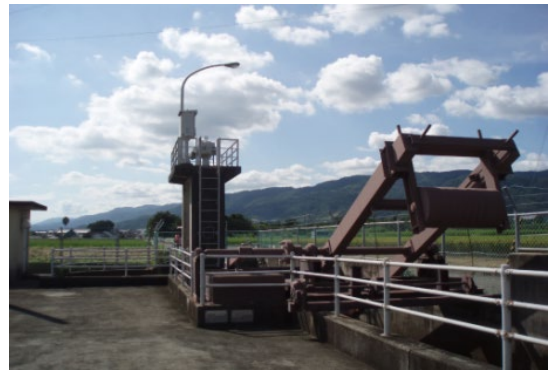
写真-20.1 水位調整ゲート(1)
