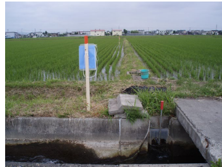
写真-6.12 水管理野帳設置状況
