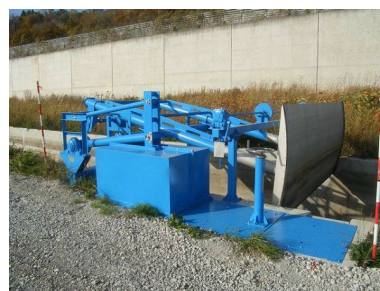
写真-20.2 水位調整ゲート(2)
