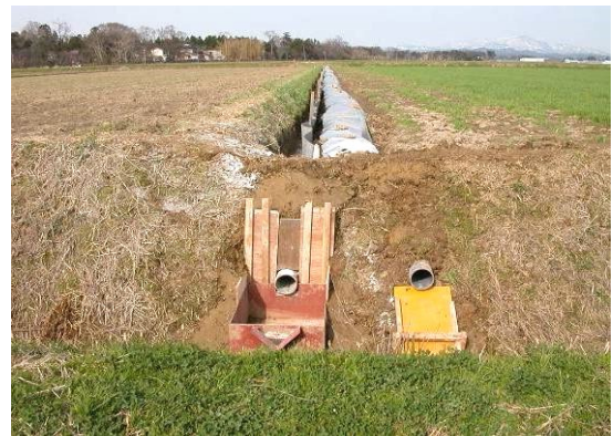
写真-6.8 流末側の三角堰設置例
