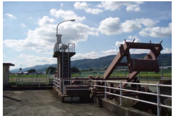
写真-20.1 水位調整ゲート(1)
