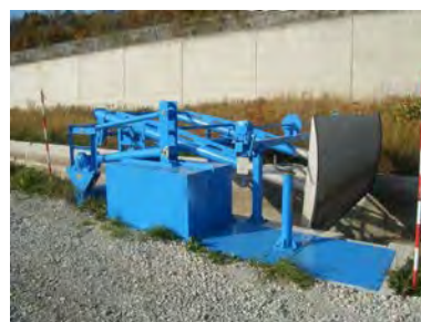
写真-20.2 水位調整ゲート(2)
