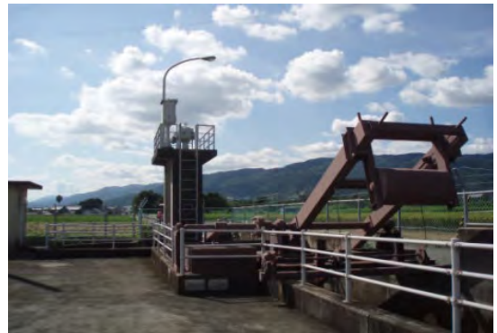
写真-20.1 水位調整ゲート(1)
