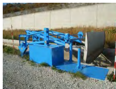
写真-20.2 水位調整ゲート(2)
