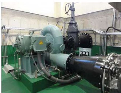
写真-41.1 水車及び発電機
