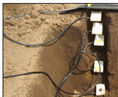
写真-5.2 誘電率水分計（TDR法）設置状況
