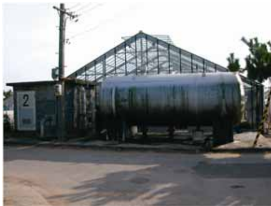
写真-6.3 老朽化の著しい現況の揚水機場及び加圧タンク
