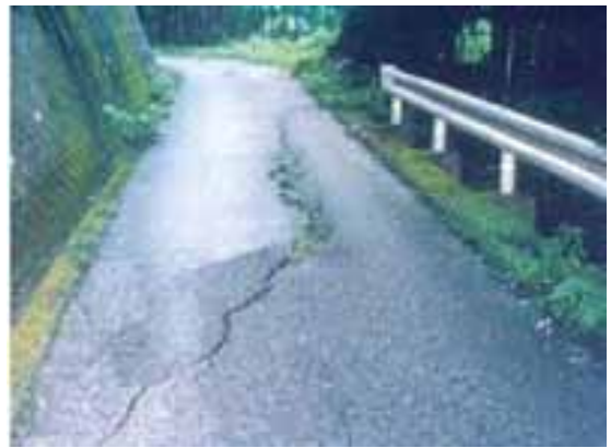
図 3-8 道路に発生した亀裂
