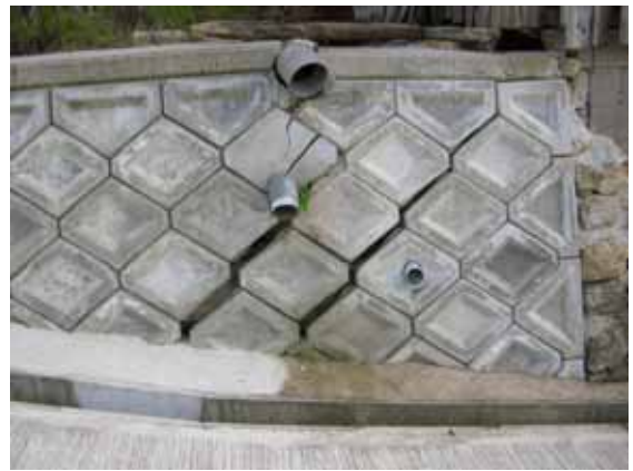
図 3-10 擁壁に発生した亀裂
