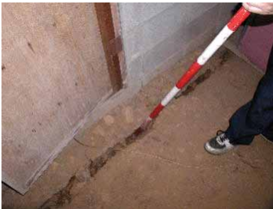
図 3-9 家屋に発生した亀裂
