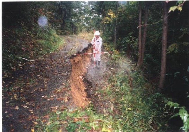
農道の路肩が崩壊
