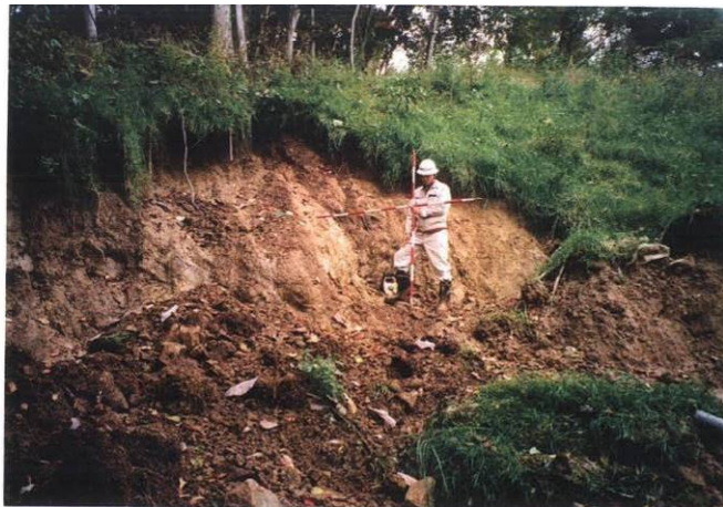
道路の法面が崩壊
