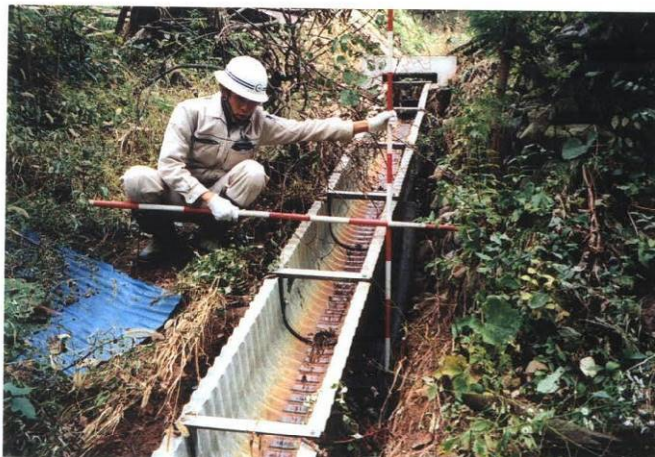
コルゲート側部が洗掘
