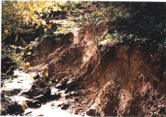
樋沢の洗掘による 斜面崩壊
