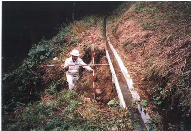
水路の法肩が崩壊
