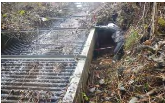
図 I -3.5.1 水路基礎地盤の洗掘によって水路が不安定化しつつある例
