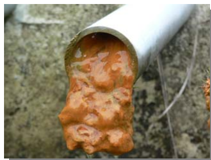
図2 目詰まりが生じた水抜きボーリング
