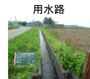
用水路 老朽化による目地欠損、 不等沈下が発生
