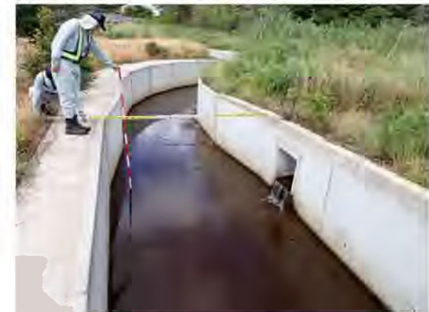
農業用排水施設
