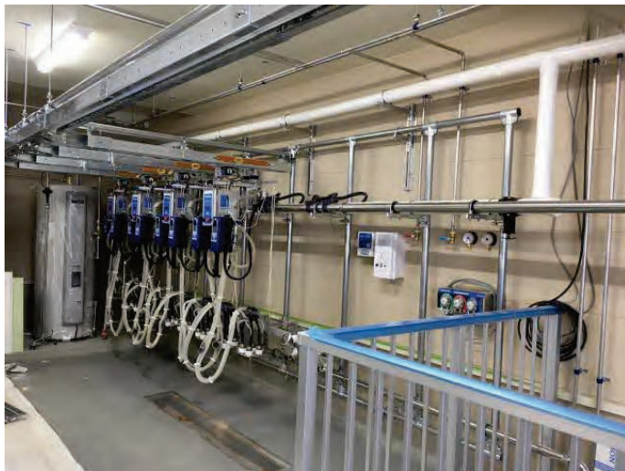
家畜保護施設（内部） 写真は つなぎ牛舎用搾乳機
