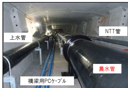
伊良部導水路 (伊良部大橋内)
