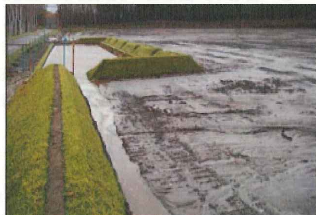
写真⑩ 大雨時降雨が沈砂池へ流れる
