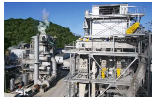
▲畜糞・鶏糞燃焼発電ボイラー
