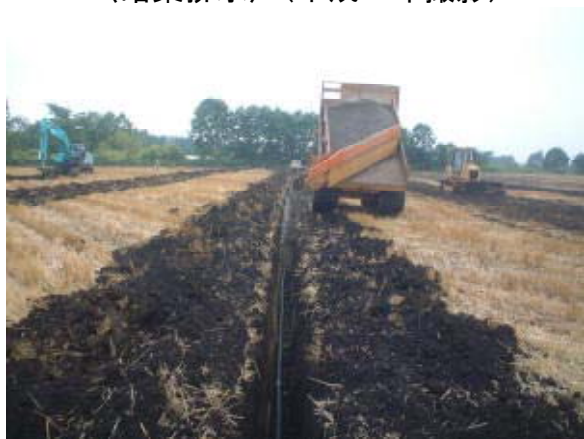
〈暗渠排水〉（平成14年撮影）
