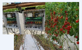
環境制御装置
