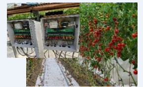
環境制御装置
