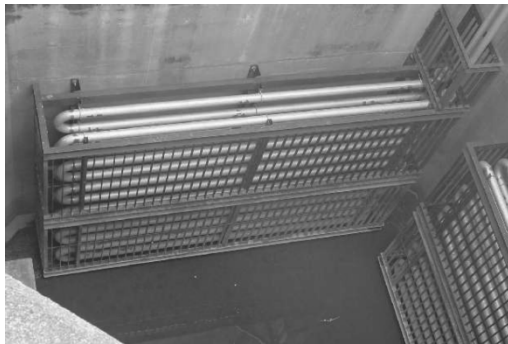
図-10.7 槽内クーラ外観（例）
