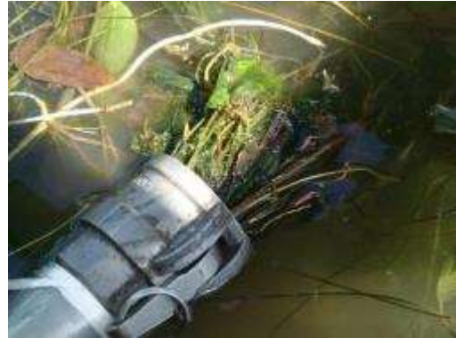
ポンプ吸込口に詰まった水草の状況
