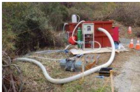
濁水処理設備
