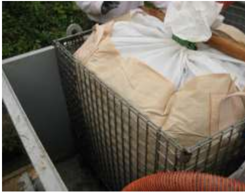
脱水カゴによる一次脱水
