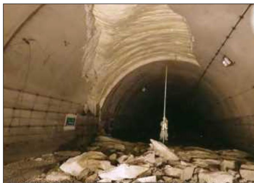
熊本地震によるトンネルの損傷
