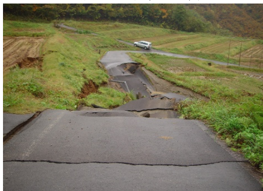
地震による道路の崩落
