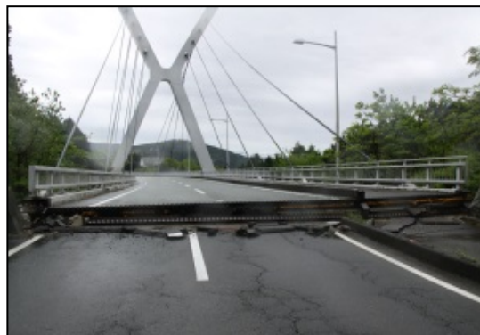
熊本地震による橋梁の損傷
