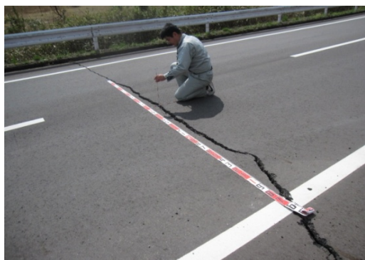
地震による舗装の亀裂
