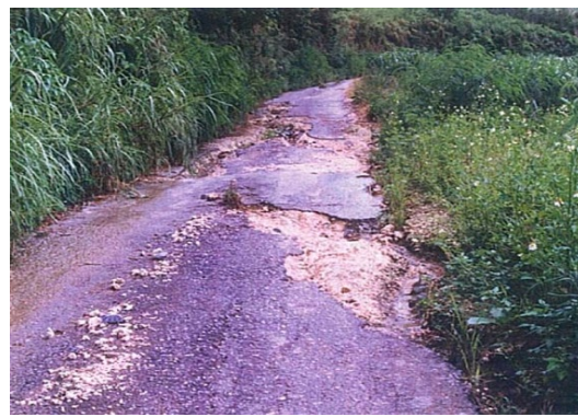
出水による舗装の流亡
