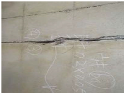
補修前の浮き・剥離1
