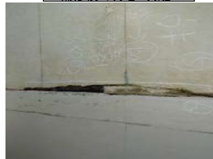
補修前の浮き・剥離2
