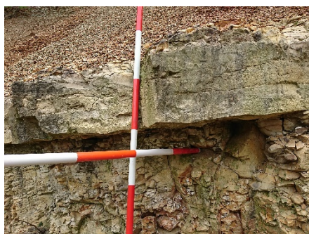
施工前の風化状況。 水を加えることで細かく碎ける。
