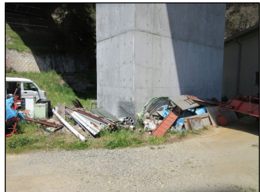
橋脚下に投棄された資材
