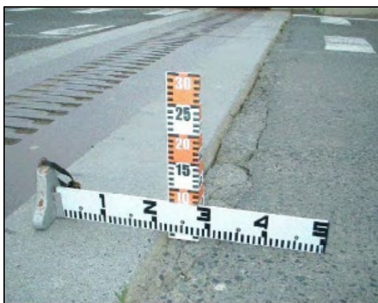
③損傷規模（伸縮装置舗装くぼみ）
