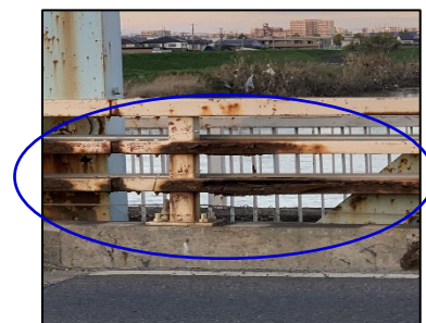
防護柵の劣化（錆・破断）
