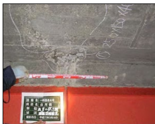
③損傷規模（床版クラック）
