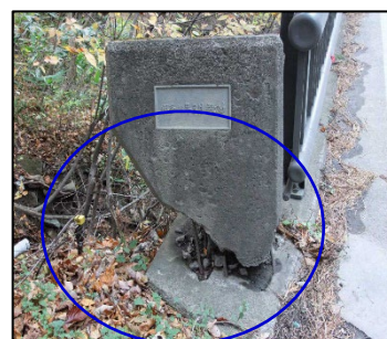
事故等による変形
