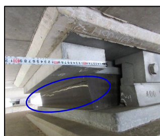
支承部（ゴム製）の壊れ （亀裂）
