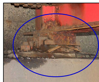
支承部（鋼製）の腐食 （錆）
