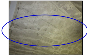
ひび割れ補修跡
