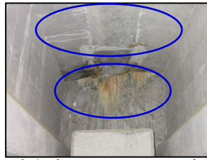
床版部分（石灰分の析出、漏水跡）
