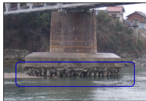
橋台下部の洗掘
