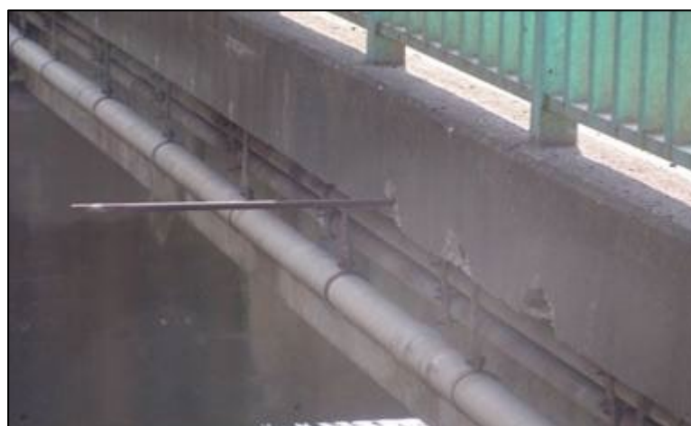
破断して突出した横締め PC 鋼材
