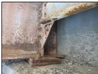
桁端部の腐食
