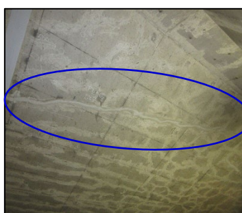
ひび割れ、補修跡
