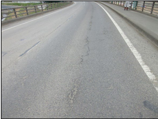
縦断方向のひび割れ
