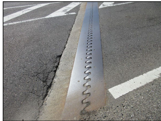
詰まりすぎ、周辺の舗装ひび割れ
