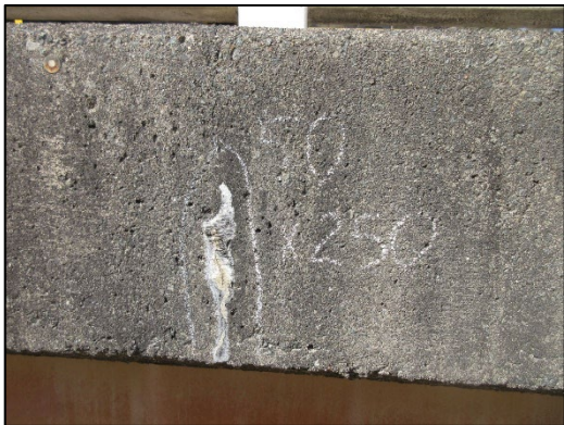
ひび割れ、析出物
