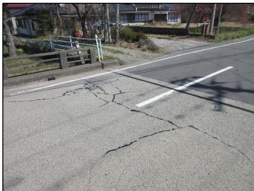
ひび割れ、補修跡
