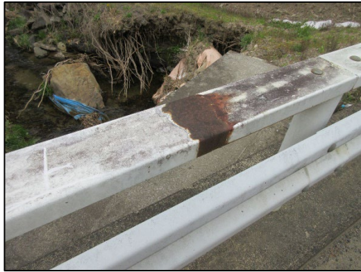
塗装剥がれ、発錆
