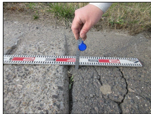
ひび割れ、段差
