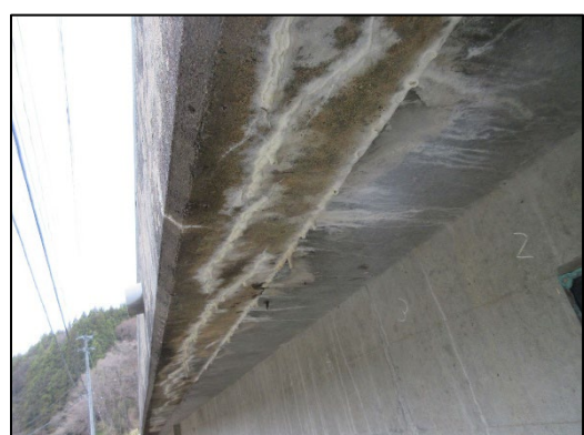
ひび割れ、析出物
