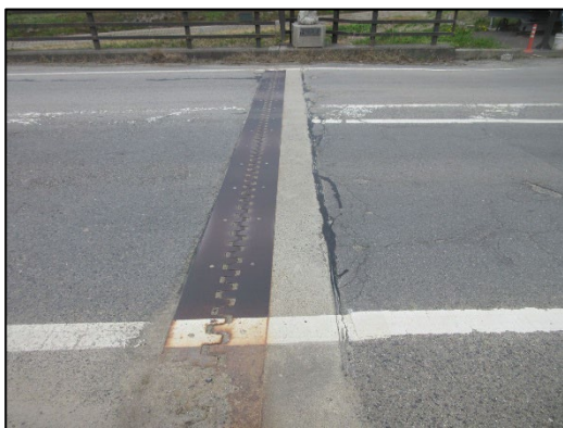
隙間土砂詰まり
