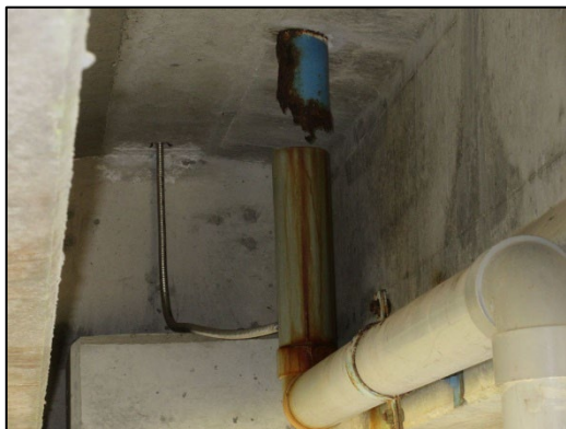
排水管腐食破断
