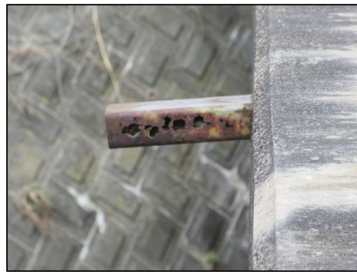
排水管腐食孔
