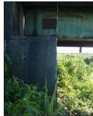
橋台の傾き (下げ振りによる測定)
