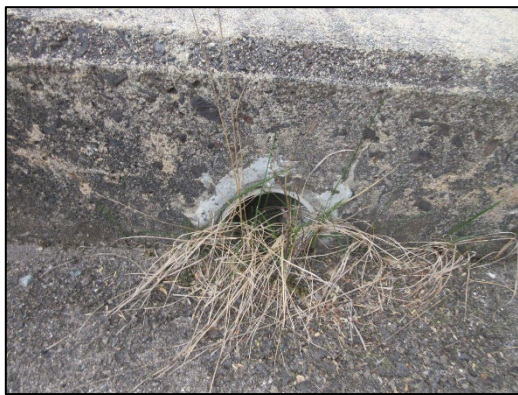
排水管土砂詰まり、草繁茂
