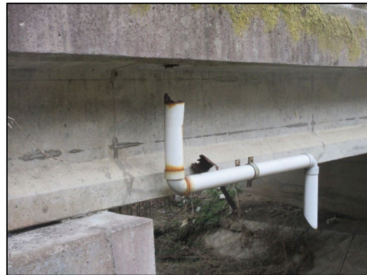
排水管腐食破断
